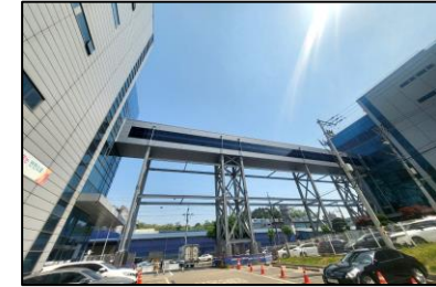
건물 일체형 태양광 발전설비
