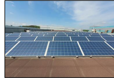
지붕형 태양광 발전설비
